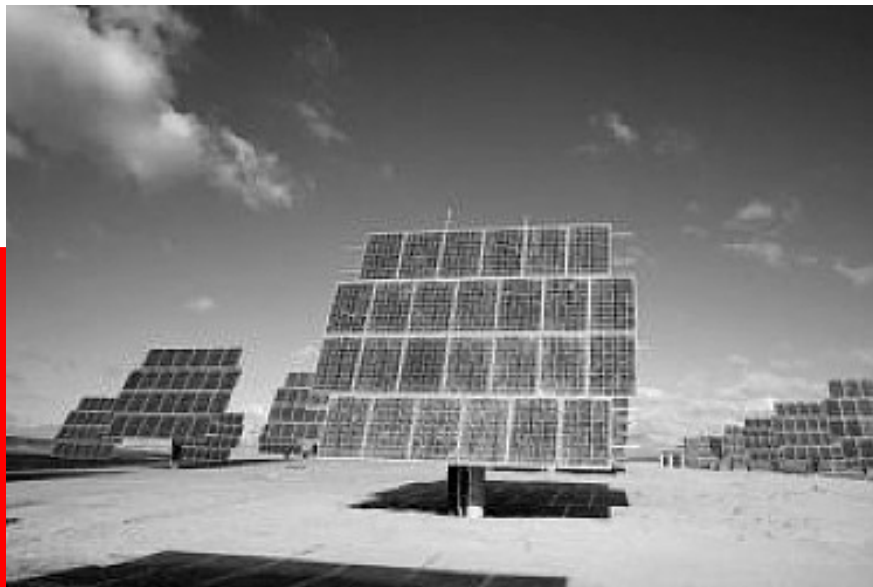
Parque fotovoltaicos con 350 Seguidores solares
